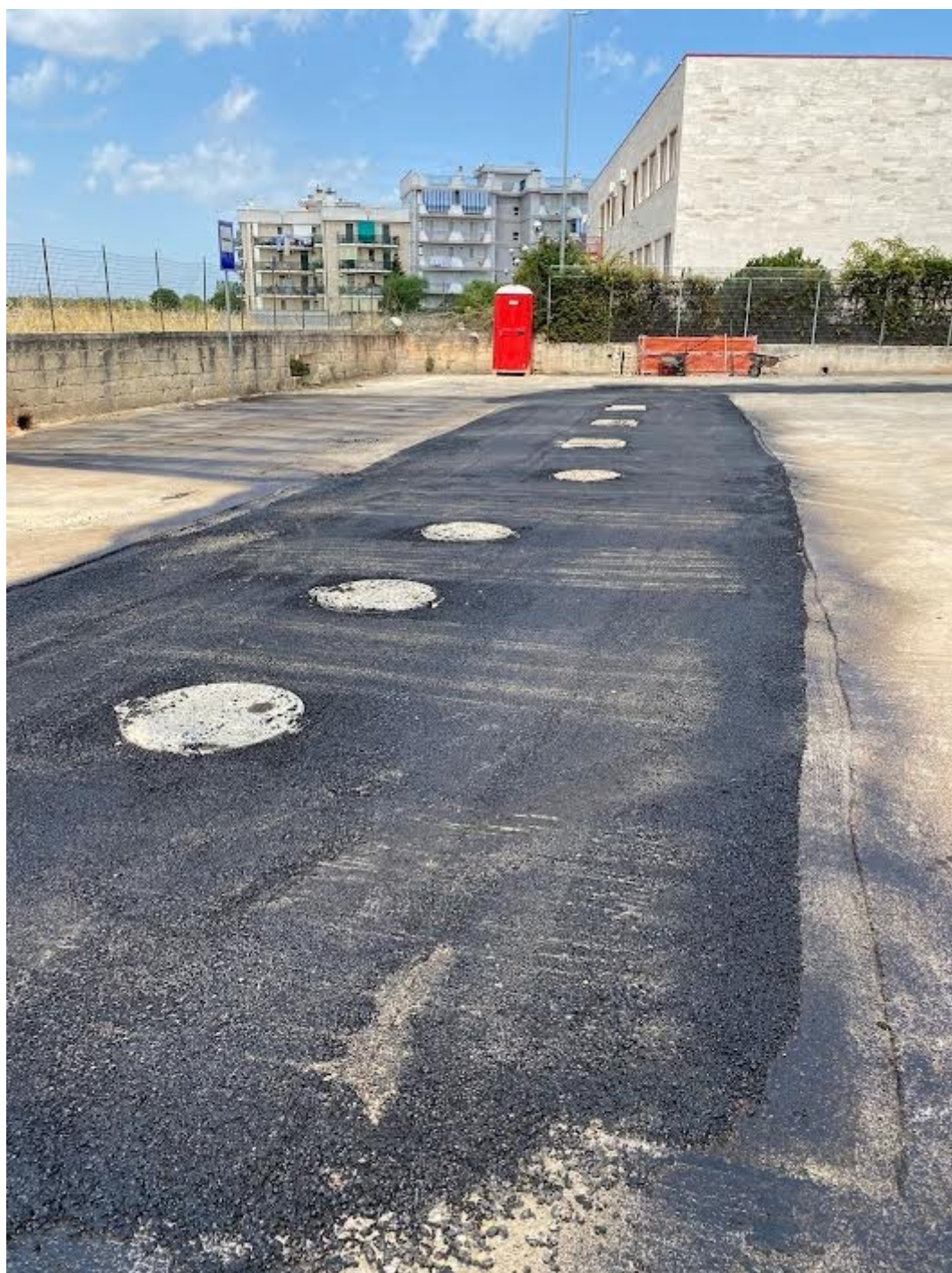
Chiusini di ispezione impianto trattamento e pozzi disperdenti
